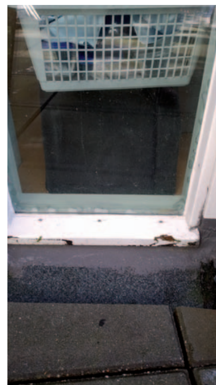
▲ Het Triflex is ook onder bij de neuslat aangebracht. De tegels liggen op hetzelfde niveau als de neuslat. De neuslat is beschadigd. Naast wolkvorming zijn ook bellen aan de rand van het glas aanwezig. Door het glas is te zien dat er geen tape om het brandwerend glas is aangebracht.
