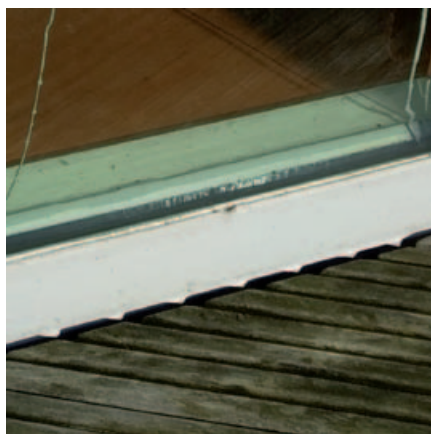
▲ Bij de brandwerende ruiten op de tweede verdieping is op één na wel tape aangebracht rond de brandwerende ruit.
