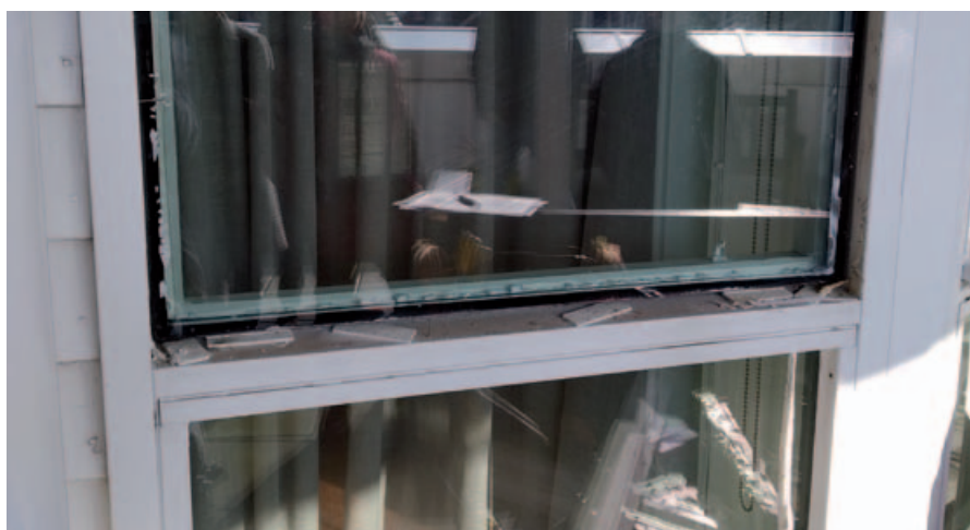
▲ Het brandwerende glas bevat hier te grote bellen waardoor de brandwerendheid niet meer gegarandeerd kan worden.
