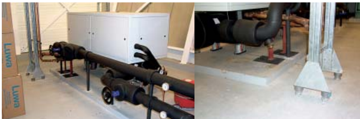
3. De koelmachine in een omkasting en de ondersteuning van koelmiddelleidingwerk en koelmachine van praktijkvoorbeeld 2.
