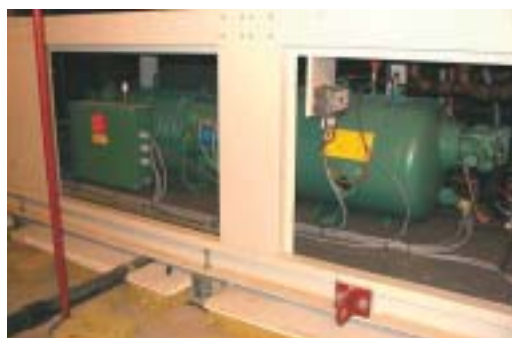
1. Diverse componenten van de koelinstallatie (van boven naar onder): de schroefcompressorkoelmachine, de drycooler, de verdeler/verzamelaar (watervoerend), de koelpomp (inbouw) en het koelmiddelleidingwerk.
