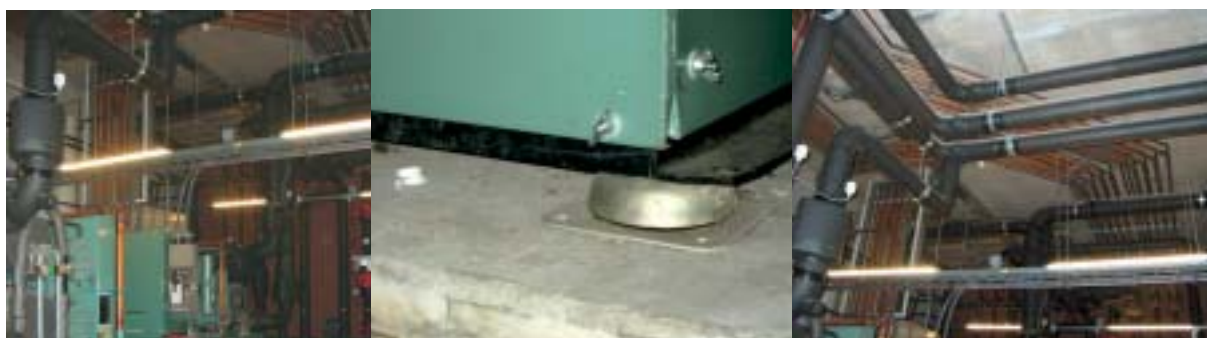
2. De koelmachine, schotelvormige trillingdemper, het watervoerend leidingwerk (zwart) en koelmiddelleidingen (koper) uit praktijkvoorbeeld 1.
