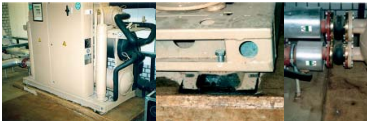
5. De schroefcompressorkoelmachine, detail van trillingdemper koelmachine en de watervoerende leidingen met compensatoren en ondersteuning uit praktijkvoorbeeld 3.
