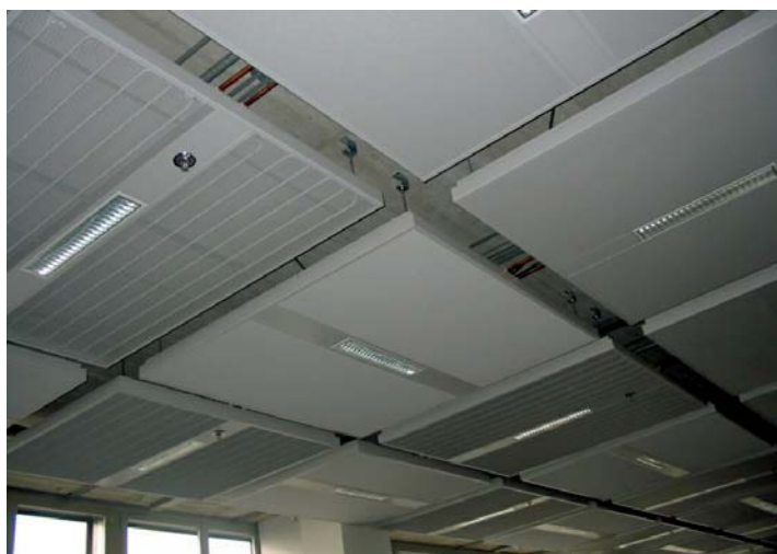
1. Voorbeeld van vrijhangende strekmetaal koelplafondeilanden.
