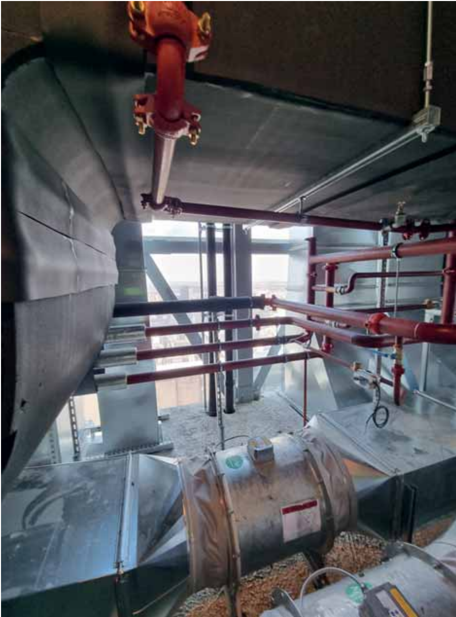
Uitzicht vanaf de Technische verdieping op de 60e etage, met de toevoer overdrukventilatoren (onderaan in het midden)
