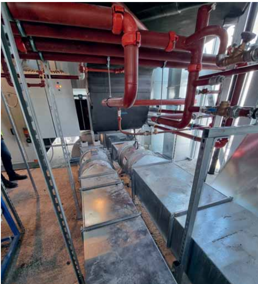
Overdrukkanalen en ventilatoren op de 60ste etage (rode buizen = sprinkler. Tevens overige installaties.)
